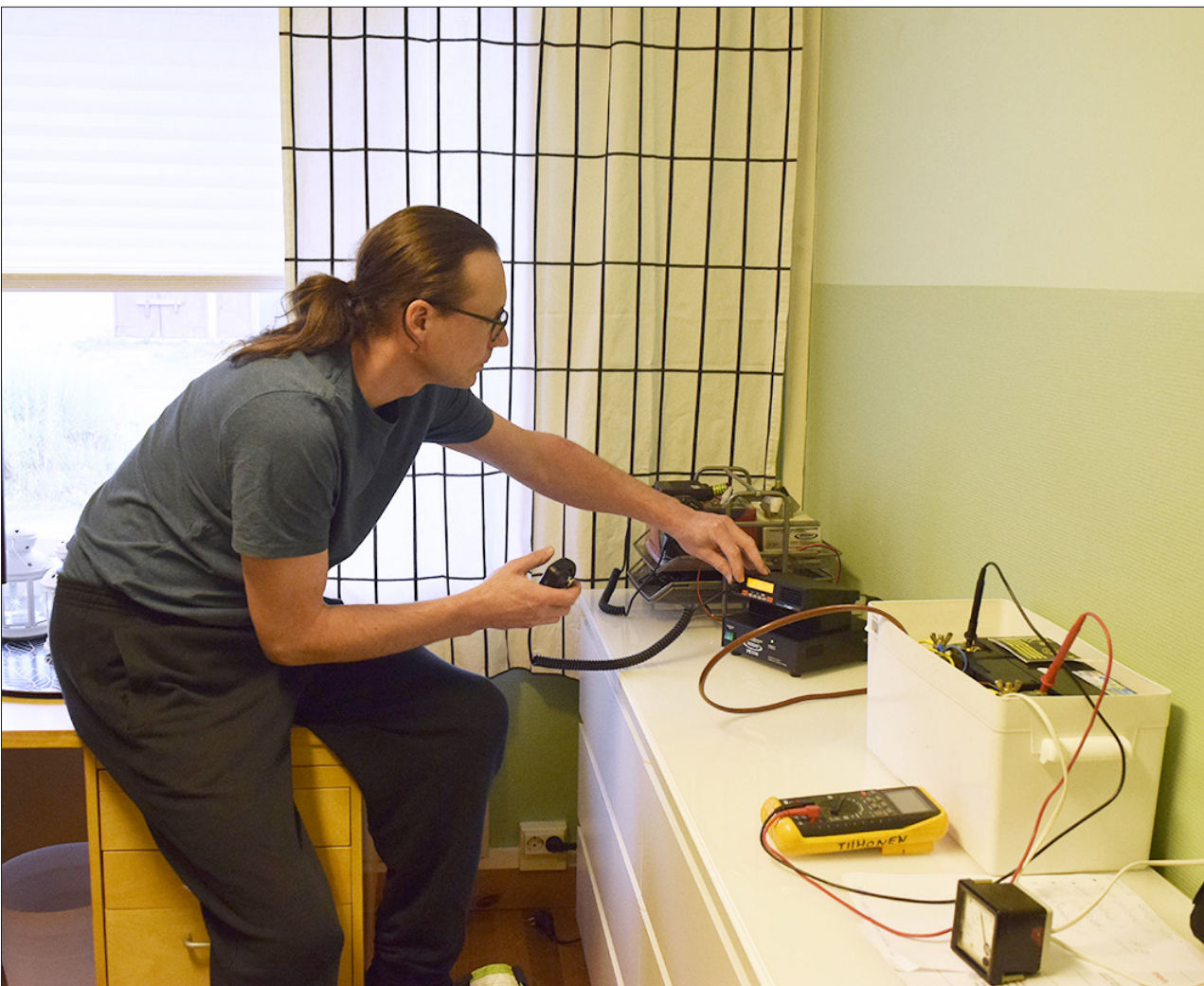
– Täällä tukiasema on asennettu siten, että jos sähköt katkeavat, se alkaa ottaa automaattisesti virtaa akusta. Eli silloin kun valot sammuvat, ei tarvitse alkaa muutella kytkentöjä, Heikki Tiihonen kertoi.
